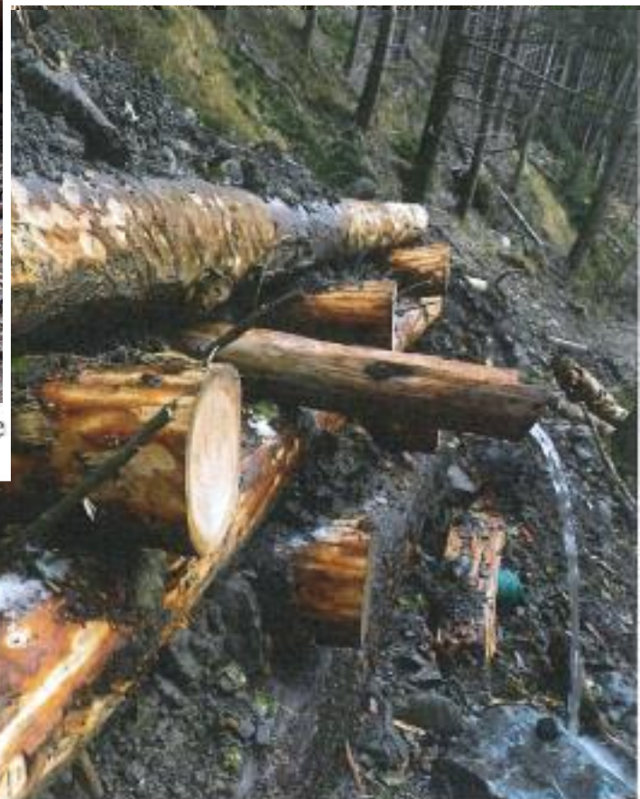
Foto 19 a – palificata per protezione al piede della strada: particolare del drenaggio sotto-strada in funzione
